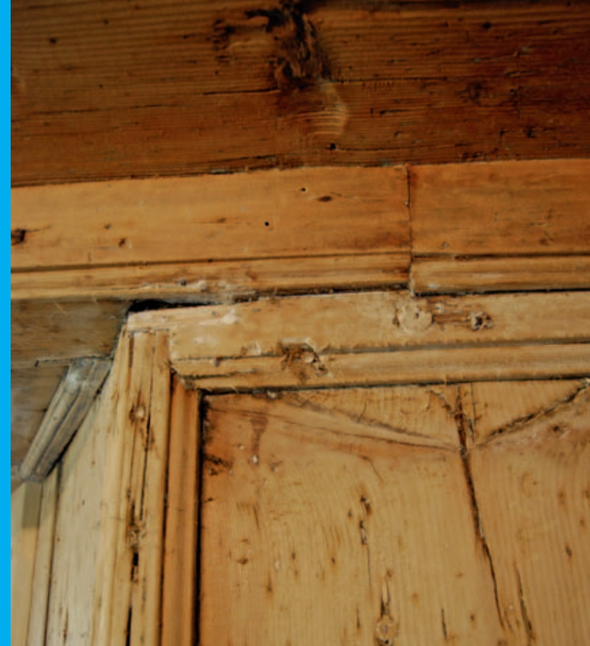
Durch unsachgemässes Ablaugen beschädigtes Täfer einer Stube aus Cazis (Mitte 15. Jahrhundert).
