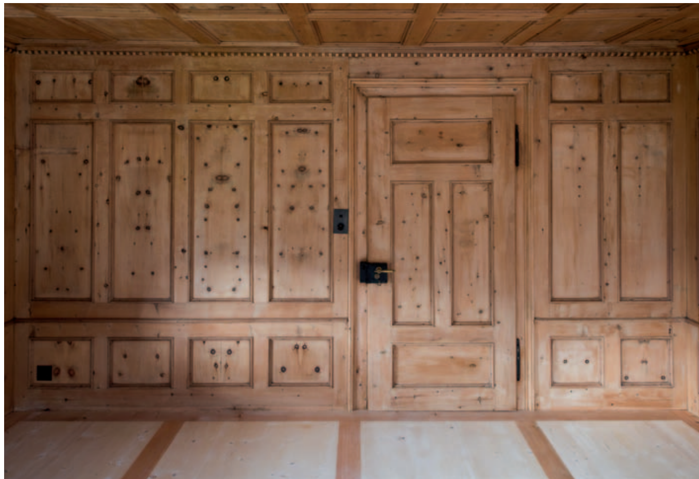
Haus F: Belle Epoque Zimmer mit neuem handgehobeltem Kassettenboden und von Wachs befreiten Holzoberflächen (Wände und Decke).
